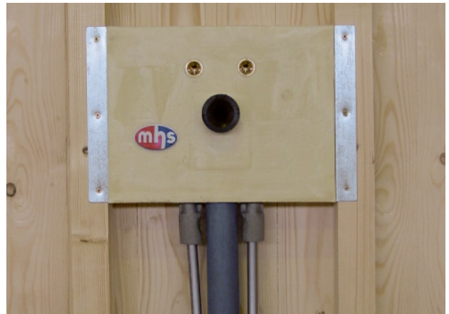
Wenn die richtige Höhe für den Wasseranschluss bzw. für den Abfluss festgelegt wurde, kann die Installationsbox mit Senkkopfschrauben auf den 5 x 8er Latten befestigt werden
