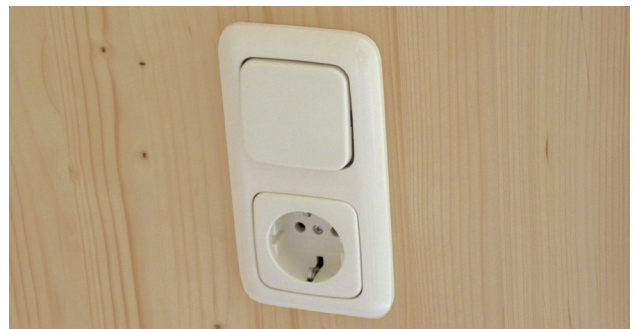
Abb. 54 - Einbau einer Steckdosen-Taster-Kombination bei Wänden mit Sichtflächen. Die Bohrung in der Sichtseite muss dem Dosendurchmesser bzw. dem Abdeckrahmen entsprechen (meist 68 mm Durchmesser)
