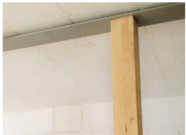
Abb. 6: Eine lineare Wärmebrücke im Entstehen. Wird der Stahlträger nicht noch in die Dämmung eingebunden, so ist Tauwasserausfall vorprogrammiert
