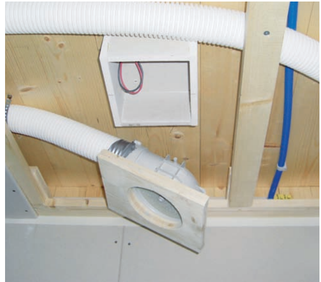
Abb. 14: Leitungsführung hinter abgehängter Decke. System HOVAL [mit freundlicher Unterstützung durch Eberle • denkfabrik •, Dornbirn, Österreich]
