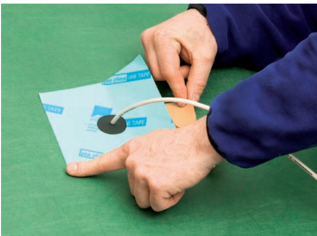
Abb. 10: Sind Durchdringungen nicht zu vermeiden, sollten zur Abdichtung geeignete und geprüfte Systeme verwendet werden. Schnelle und dauerhaft dichte Montage rechtfertigen die Mehrkosten [mit freundlicher Unterstützung der Firma pro clima 2011]
