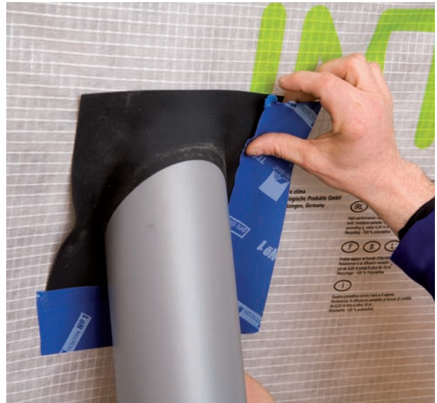
Abb. 11: Sind Durchdringungen nicht zu vermeiden, sollten zur Abdichtung geeignete und geprüfte Systeme verwendet werden. Schnelle und dauerhaft dichte Montage rechtfertigen die Mehrkosten [mit freundlicher Unterstützung der Firma pro clima 2011]
