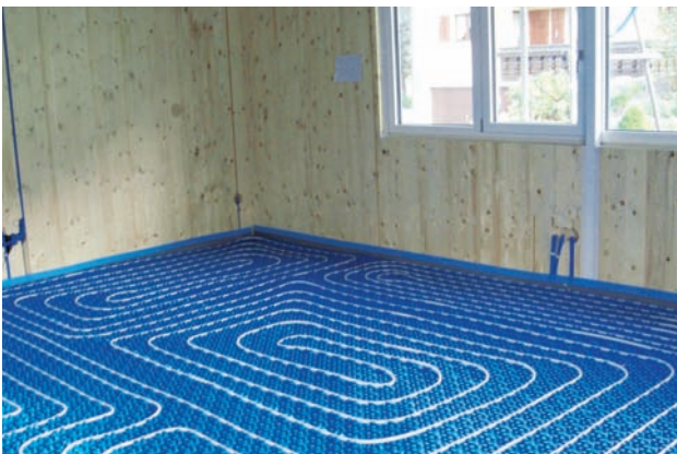
Abb. 15: Verrohrung einer Fußbodenheizung [mit freundlicher Unterstützung durch Eberle • d e n k f a b r i k •, Dornbirn, Österreich]
